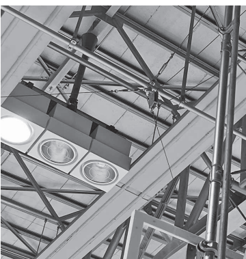
▲照明の交換が困難なスポーツセンター
