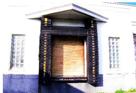
(老朽化した給食センター給食配送口)
