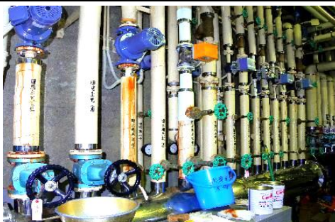
(老朽化した給排水・蒸気配管)
