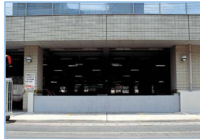
施設内の浸水を防ぐスライド式防水板 引用元 (株)オカムラ
