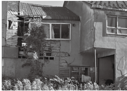
▲「危険な空き家」の対応策は
