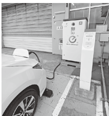
▲11月頃に道の駅をもいに急速充電器を設置(イメージ写真)
