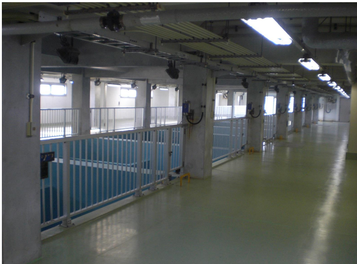
新信砂浄水場 急速ろ過池
