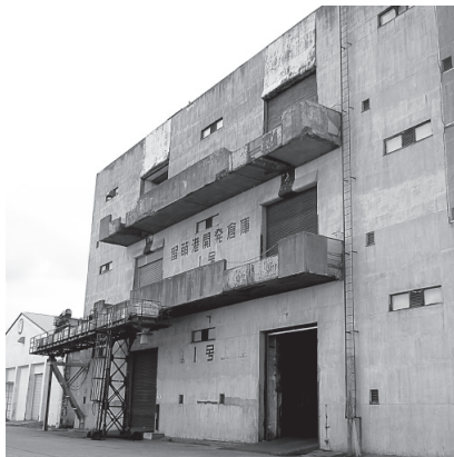
▲外壁が剥離している留萌港南岸の小麦倉庫
