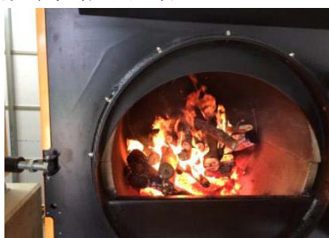
ボイラー内 1 次燃焼室(ガス化)
