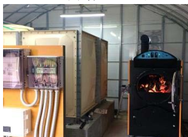
資源循環型バイオマス燃焼ボイラー(右)と貯湯タンク(左)
