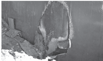
▲火災発生箇所の焼損状況
