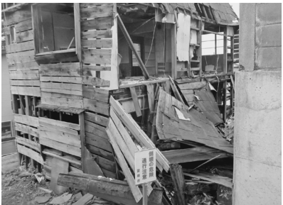
▲深刻化する「危険空き家」
