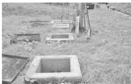
▲幌糠専用水道沈砂池
