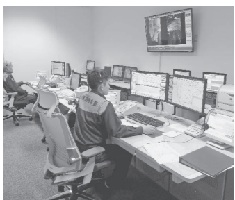
▲新しくなった消防施設の消防緊急通信指令台
