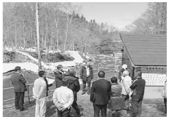
▲老朽化が著しい取水施設（新信砂）
