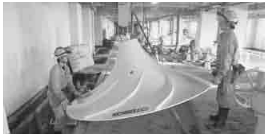
水処理施設内に設置する攪拌装置の設置状況
