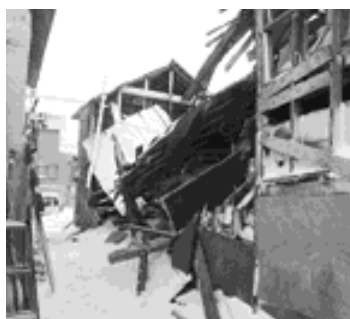
危険倒壊家屋
