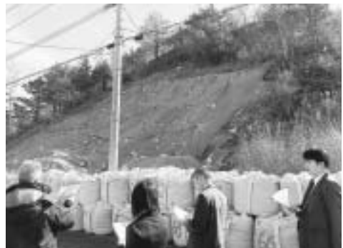
千鳥町自由ヶ丘、法面災害現場
