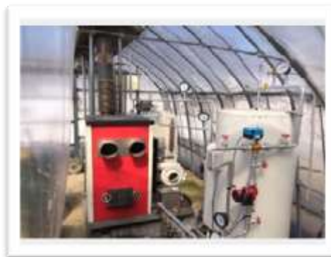
廃食油を用いた加温ヒーターと温水ユニット
