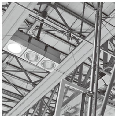
▲不具合のあるスポーツセンター照明
