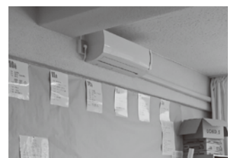
▲設置が予定される空調設備
