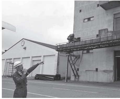
▲老朽化が激しい昭和42年建設のバラ化 小麦倉庫
