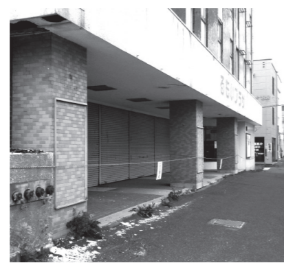
▲入口の天井壁はく離で立入禁止措置になっている旧るもいプラザ
