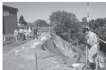
▲法面が崩壊した見晴39号通り
