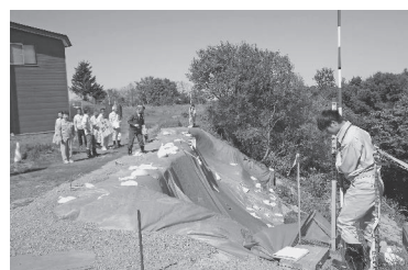
▲法面が崩壊した見晴39号通り
