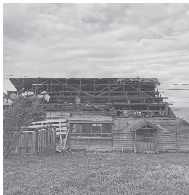
▲屋根半面が飛散した旧佐賀家漁場の「母屋」
