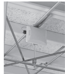
公共施設設置のWi-Fi
