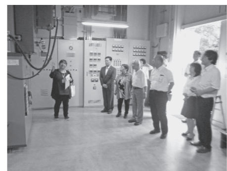
木質バイオマスボイラーを見学する議員
