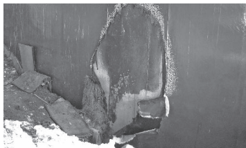
▲火災発生箇所の焼損状況
