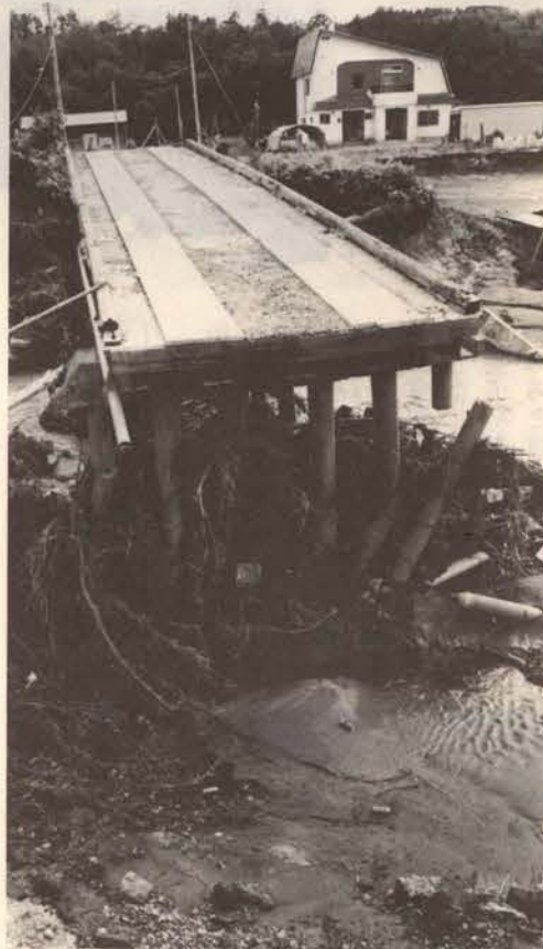
▲二つに割れた橋（幌糠地区）
