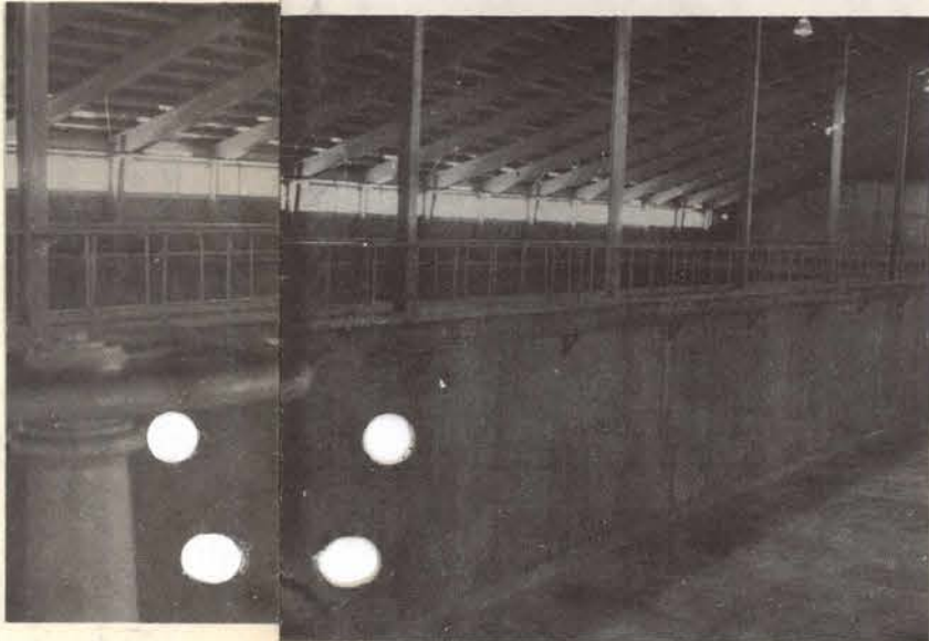
貯水能力15,000トンの貯水槽
