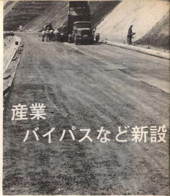
春日町から五十嵐町へ抜ける新設された産業道路は185m舗装される
