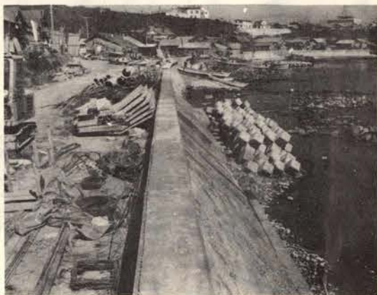
近年とくに浸蝕の激しくなった瀬越~浜中間2K900mの護岸工事は急ピッチ、49年完成目標に
